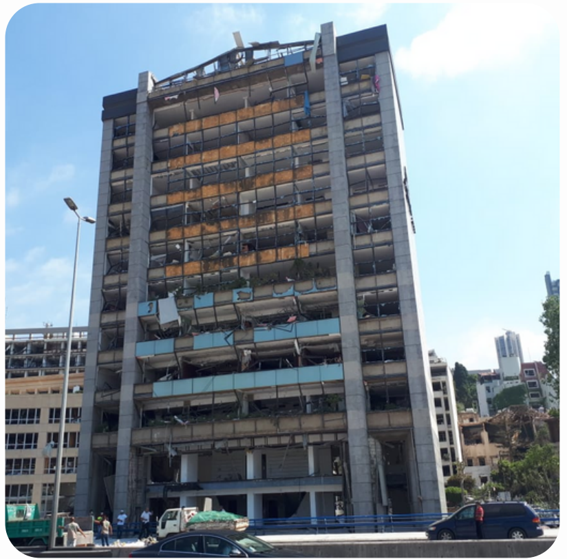
Conséquences des explosions dans le port de Beyrouth sur un immeuble. © Freimut Bahlo
